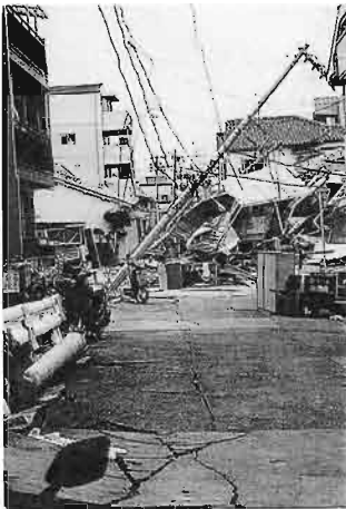
家屋や電柱の倒壊により閉塞した8m道路(東灘区、2月12日) 出典：大阪大学『阪神淡路大震災における避難所の研究』
